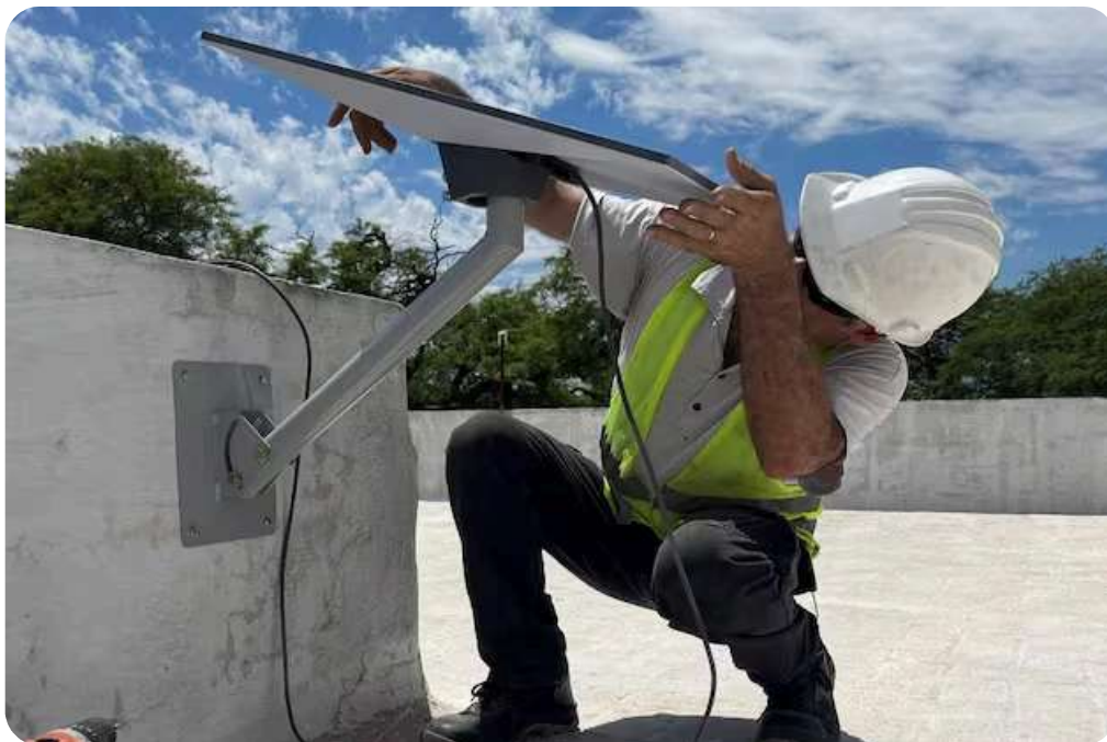
Conectividad en zonas rurales de Córdoba: Starlink en escuelas. (Provincia)
